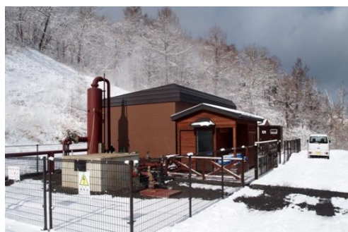
図 2-10 町内地熱発電所 出典：環境省「温泉熱事例集」
